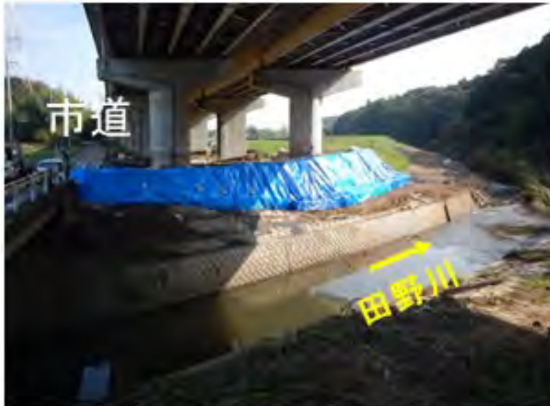
護岸破壊箇所全景 延長50mうち26.6m全壊
