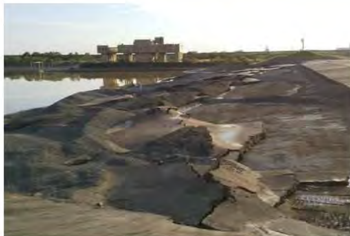
図-3 流入堤被災(上:全景斜め撮影,下:地上撮影(上写真の矢印起点で矢印方向に撮影))
