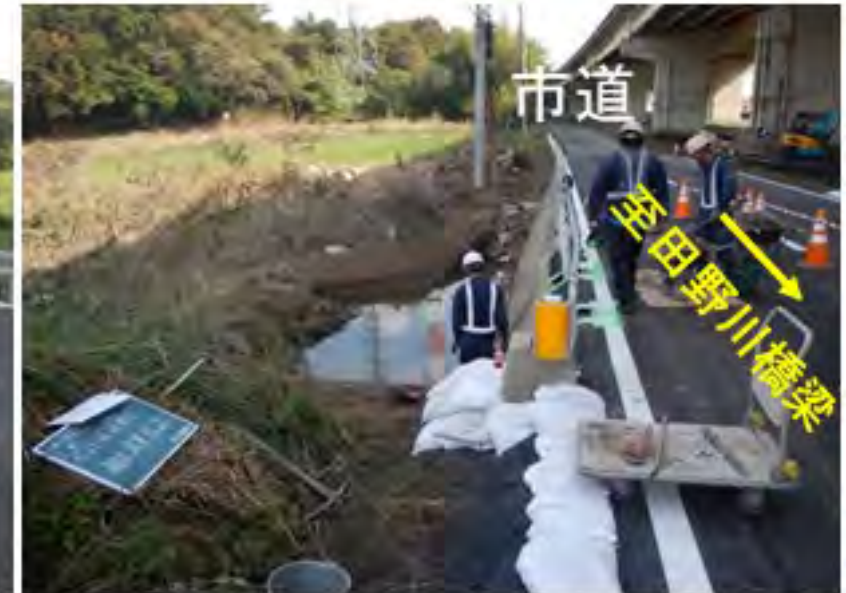
市道上流側の洗掘状況
